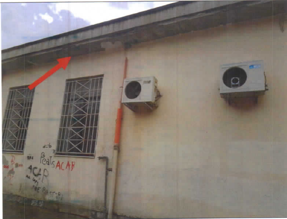
Caduta intonaco ripristino dei cornicioni
