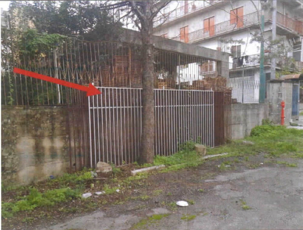
Caduta cancello RIMOZIONE IMMEDIATA.
