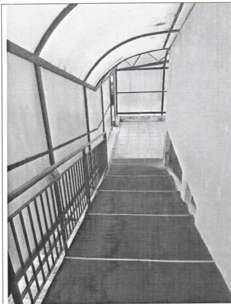
Adeguamento della relativa discesa reparto mensa, la stessa non risulta idonea di pendenza.
