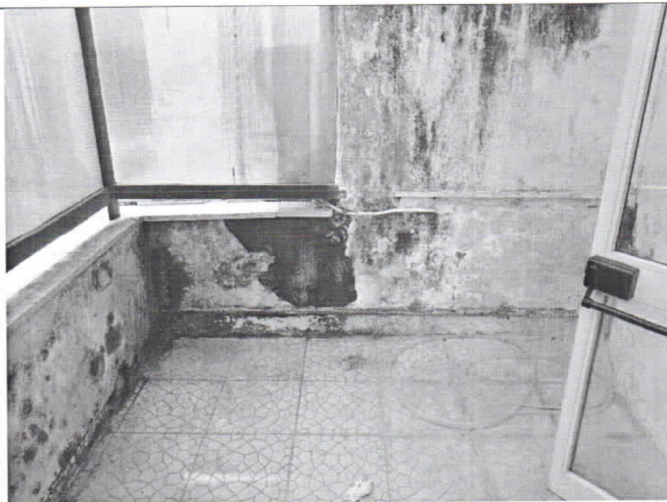
Ripristino della relativa muffa e umidità-
